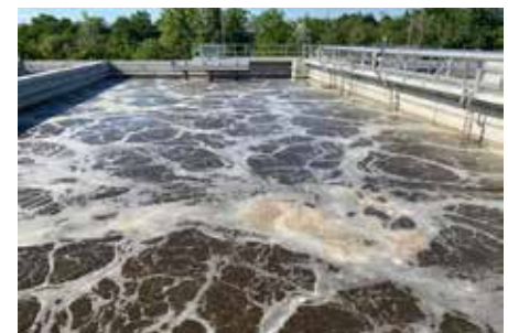
SBR Becken der Kläranlage während der Belüftungsphase (Foto: GGK)
