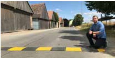
Tempeschwellen: Zur Erhöhung der Verkehrssicherheit und zur Reduktion von Geschwindigkeitsübertretungen wurden auf ausgewählten Straßen/Gassen/Wegen Tempeschwellen installiert.
